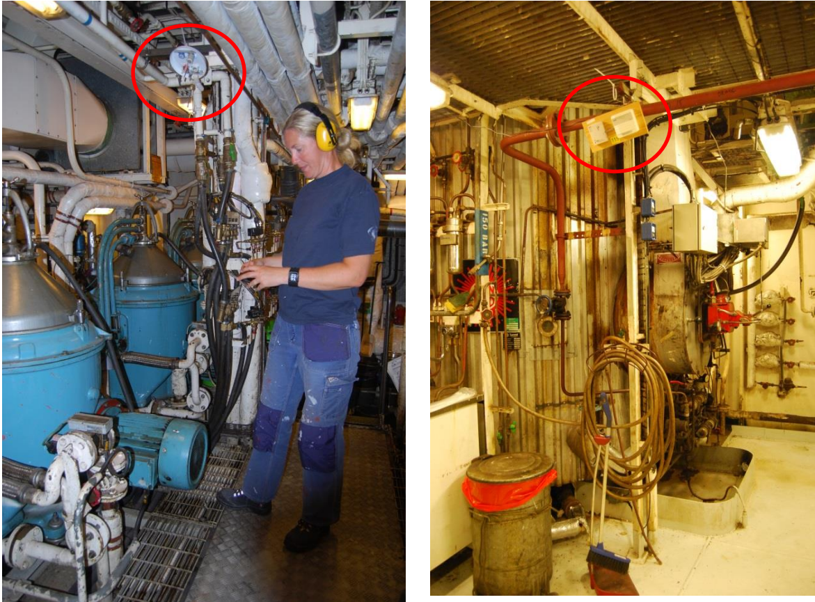
Figur 2. Sensorer för temperatur och relativ luftfuktighet i ett maskinrum (vänster bild, röd cirkel) och arbetet med mätningar i ett separatorrum. Den röda cirkeln markerar placering av diffusiva provtagare i separatorrummet
