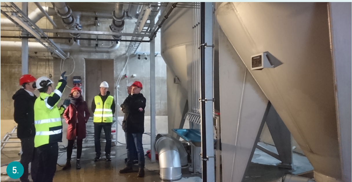
1. Dynadisc mikrofiltrering 2. Xylem ozonering 3. Dynasand sandfilter 4. Dynasand granulerat aktivt kol 5. Under byggnationen av det extra reningssteget
